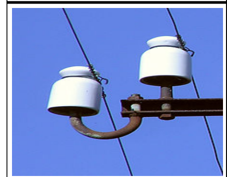
Elektrischhäuschen Riehen Isolatoren
